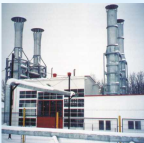
Stația de cogenerare Suplacu de Barcău cu două grupuri turbine pe gaz tip GTE 1800 (2x1800kW)
