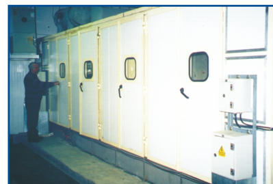
Celulă grup turbogenerator
