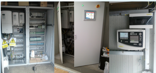
Instalația de forță și automatizare
